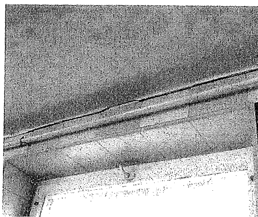
BELSŐ KÖRNYEZET - HÁTSÓ (udvari) HATÁRFAL FALTÖRÉSES REPEDÉSEK (falkidulás - kifordulás)
