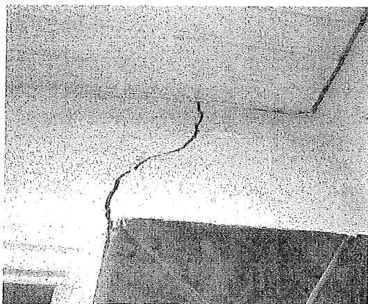
BELSŐ KÖRNYEZET - HÁTSÓ (udvari) HATÁRFAL FALTÖRÉSES REPEDÉSEK (nagy falkimozdulás)
